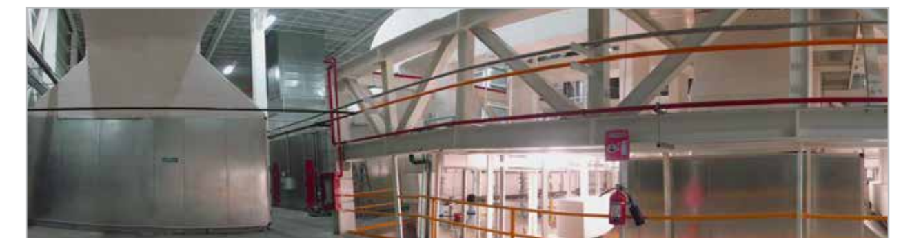
Unidad de tratamiento del aire (UTA) con su sistema de distribución de ductos de aire para la producción de fibra de vidrio
