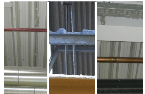
El problema: Acumulaciones de polvo en las tuberías, troncos de cables y estructuras del techo
