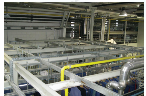
El problema: Depósitos de polvo en la zona del techo
