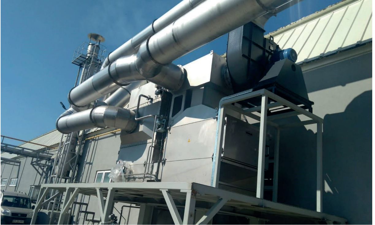
Mounted KMA heat recovery and exhaust air purification system right next to the Paşa production building Paşa Tekstil üretim binasının hemen yanına monte edilmiş KMA ısı geri kazanım ve egzoz havası arıtma sistemi
