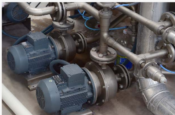
İlave Tankları Dozaj Pompaları Additional Tank Dosing Pumps
