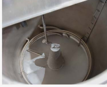
İlave Tankı İç Yapısı Additional Tank Inner Structure
