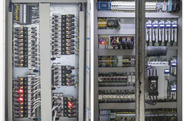
Kontrol Panoları Control Panels
